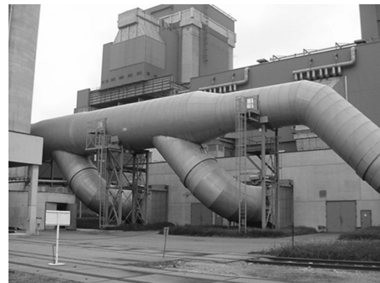
Fig. 6 Duernrohr発電所の脱硝装置の位置
